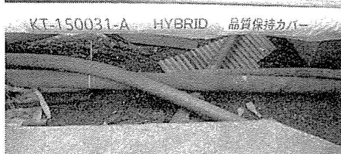
配管に巻くタイプも採用
